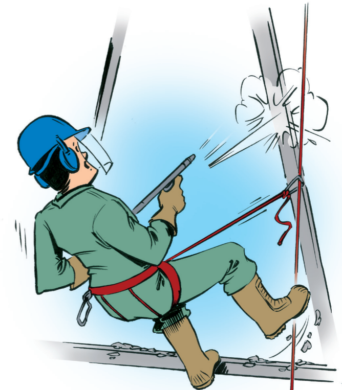
Attention à ne pas glisser sur les cornières mouillées et recouvertes de déchets de peinture ⑥
